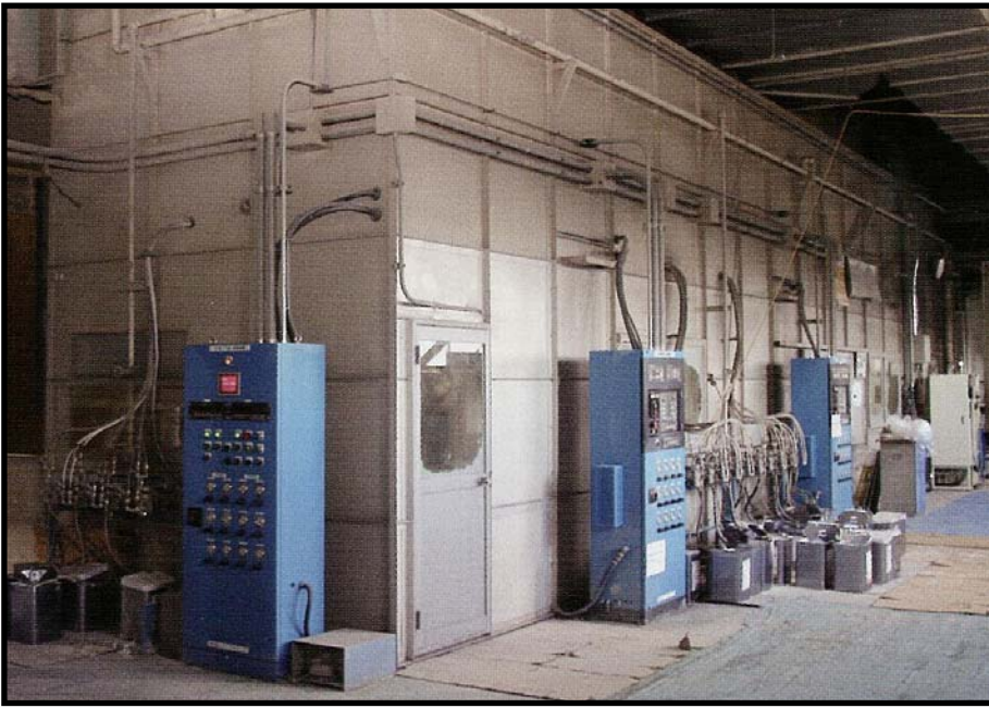
▲自動静電塗装ブースの全景
