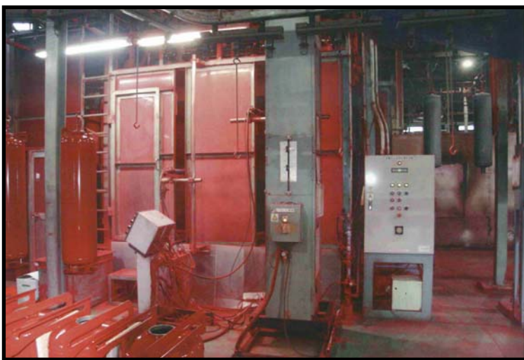
▲消火器外面の粉体塗装ブースの概要
