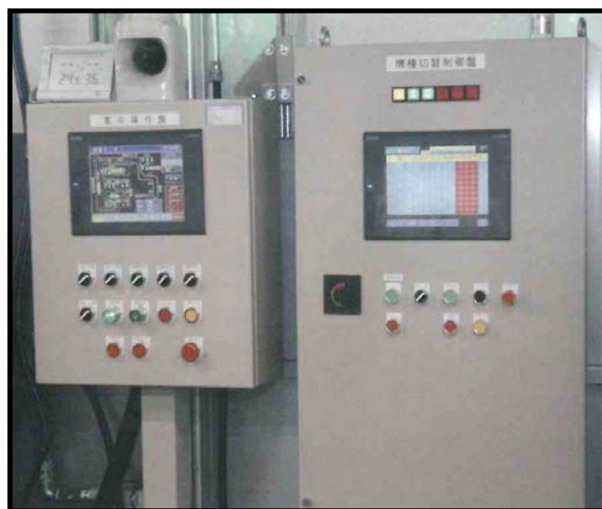
▲機種切り替え制御盤
