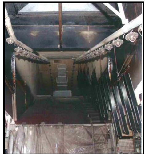
▲焼き付け乾燥炉出入り口
