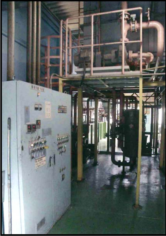
▲電着塗装の付帯設備
