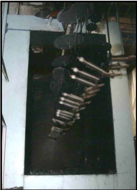
▲前処理設備(電着/溶剤・粉体ライン 共通)入り口
