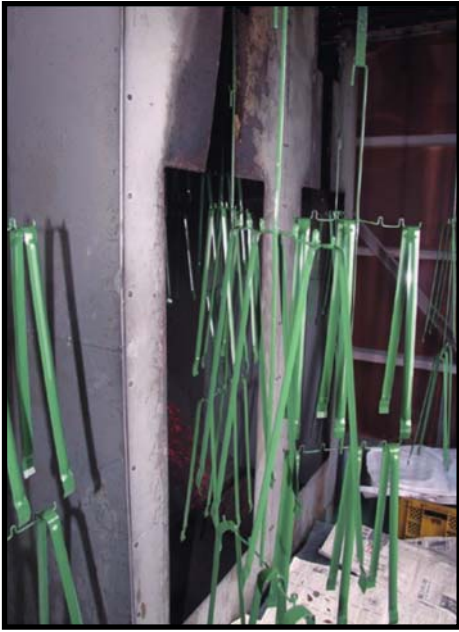
▲焼き付け乾燥炉出入り口
