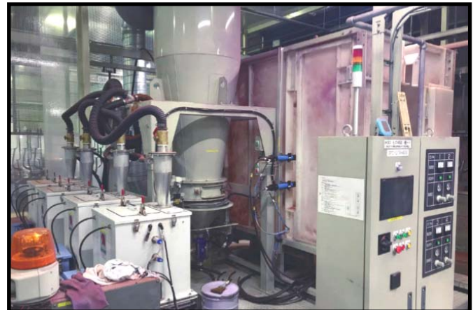
▲色替え塗装ブース(移動式)の外回り
