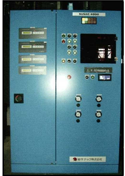
▲塗装制御盤(SUNAC4000)
