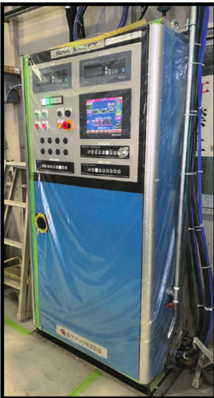
▲塗装制御盤 (SUNAC5000EX)
