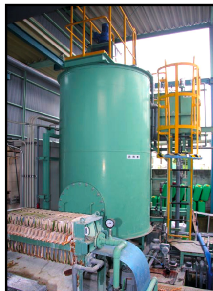
▲廃水処理設備
