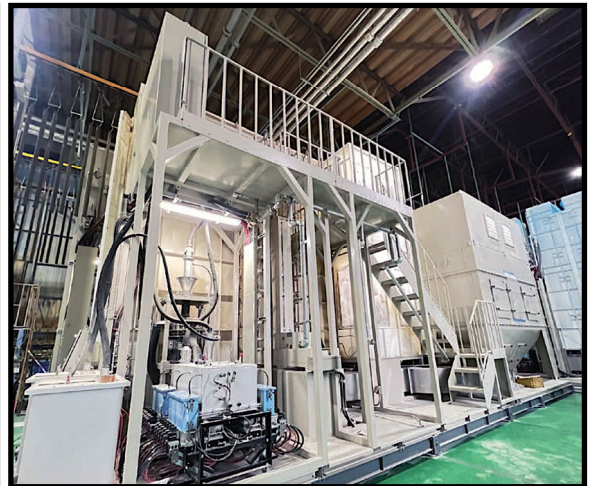
▲移動式の粉体塗装ブースシステムの全容
