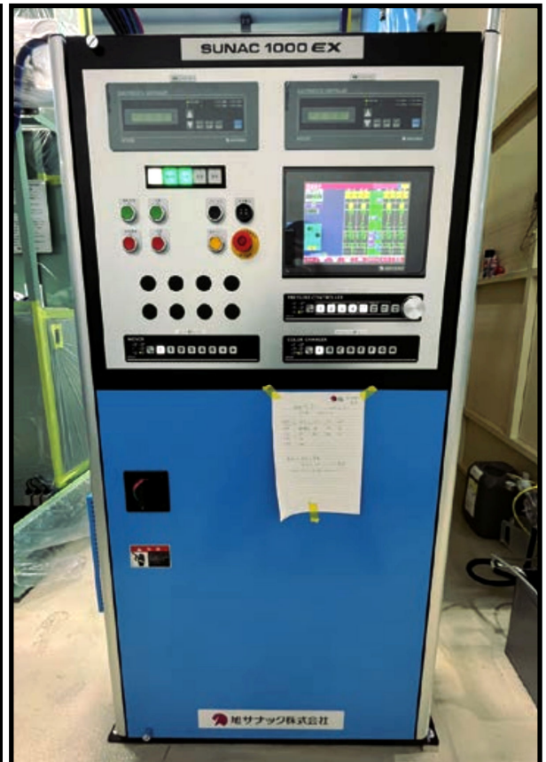
▲塗装制御盤 (SUNAC1200EX)
