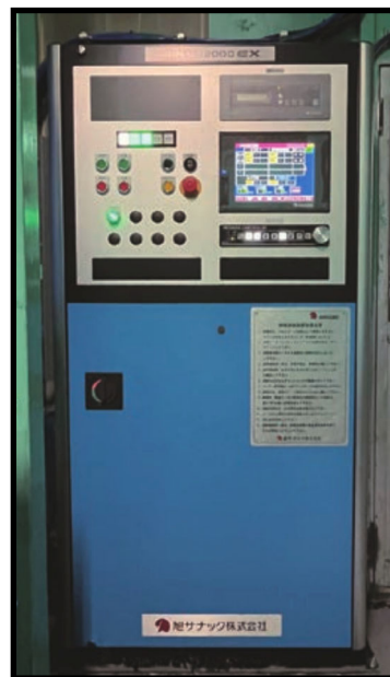
▲塗装制御盤 (SUNAC2000EX)
