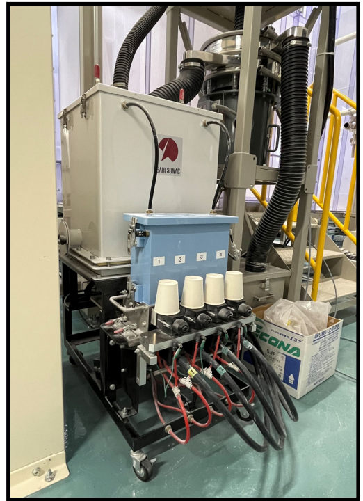
▲定量供給装置(手前)と 振動ふるい機(奥)
