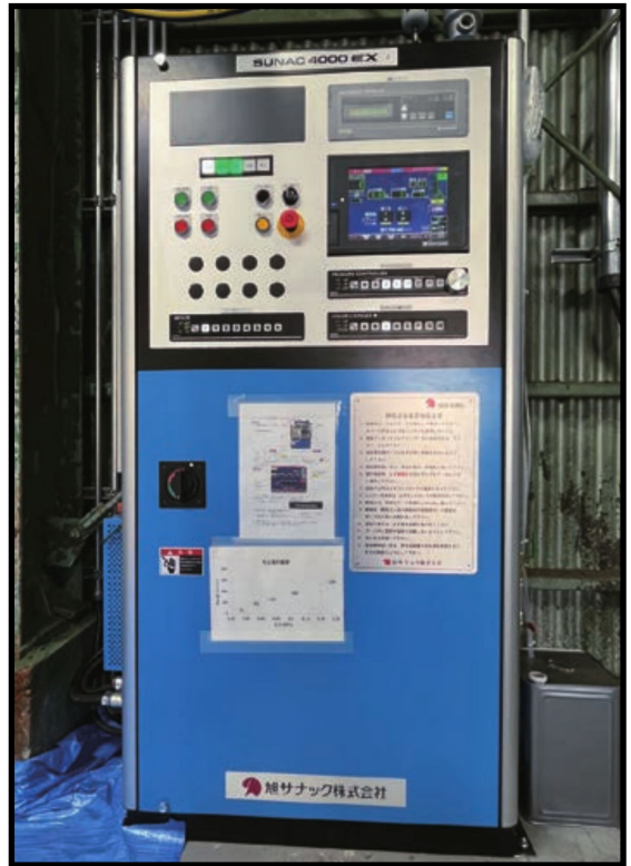
▲ 塗装制御盤 (SUNAC4000EX)
