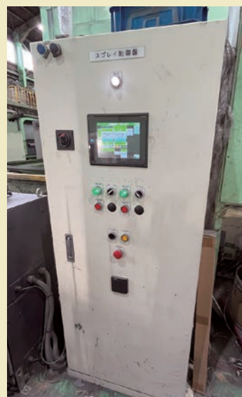
スプレー制御盤
