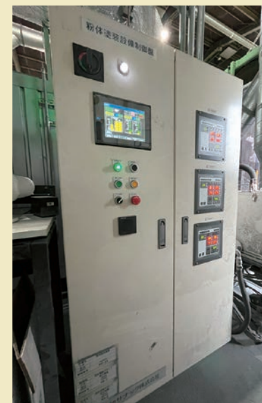
粉体塗装制御盤
