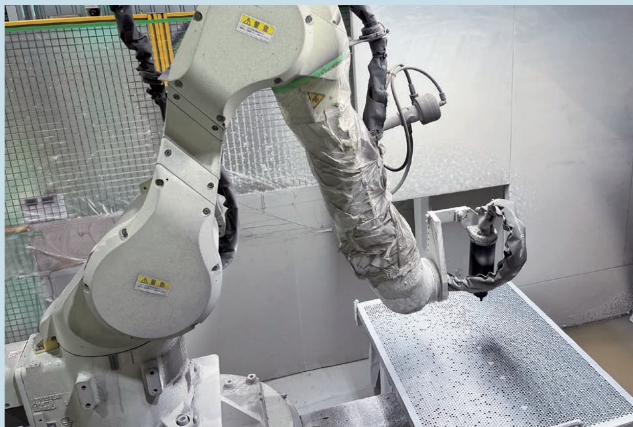
塗装ロボットに最適なエア静電自動ガン・ロボガンⅢ・EAB400を装着したロボット塗装システム
