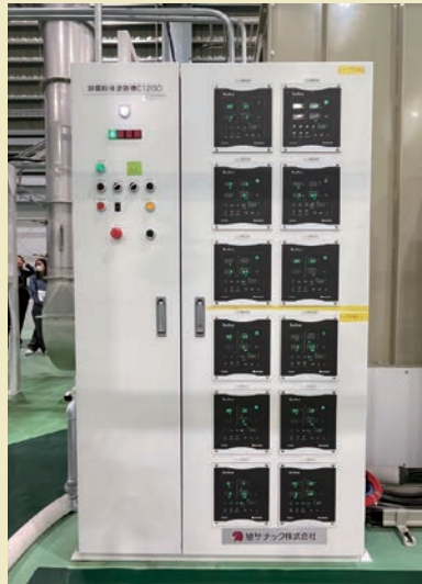
粉体塗装ガン制御盤
