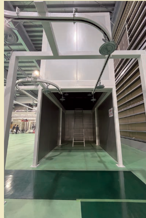
焼き付け乾燥炉は下・上塗り共用
