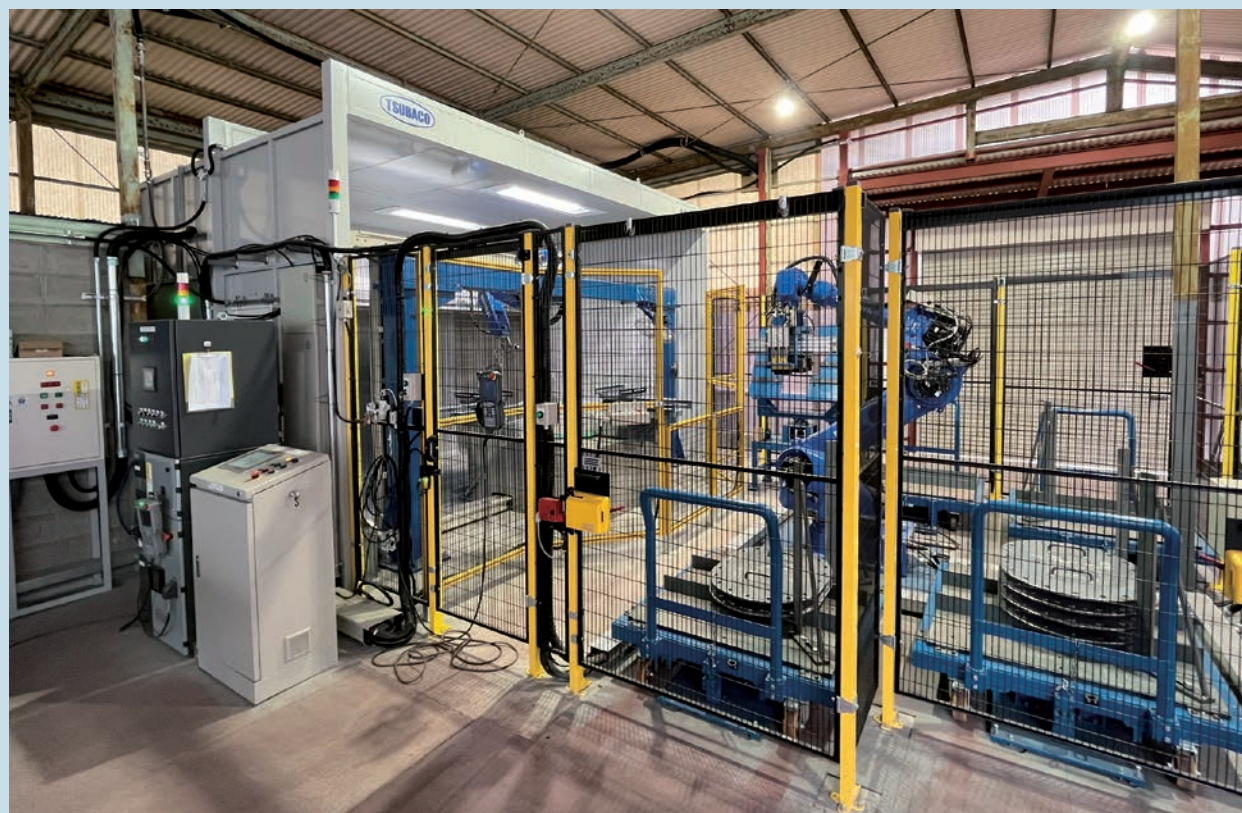
塗装ロボットとハンドリングロボットが連動する塗装設備
