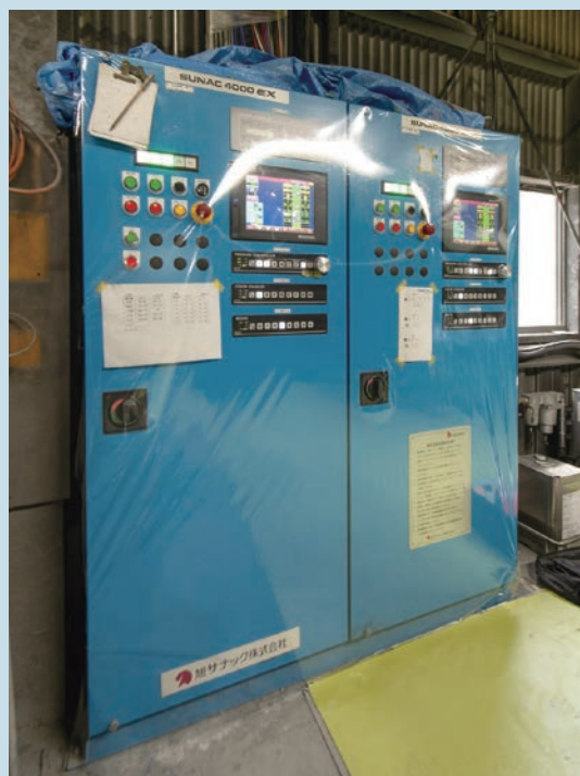
塗装制御盤 (SUNAC 4000EX)
