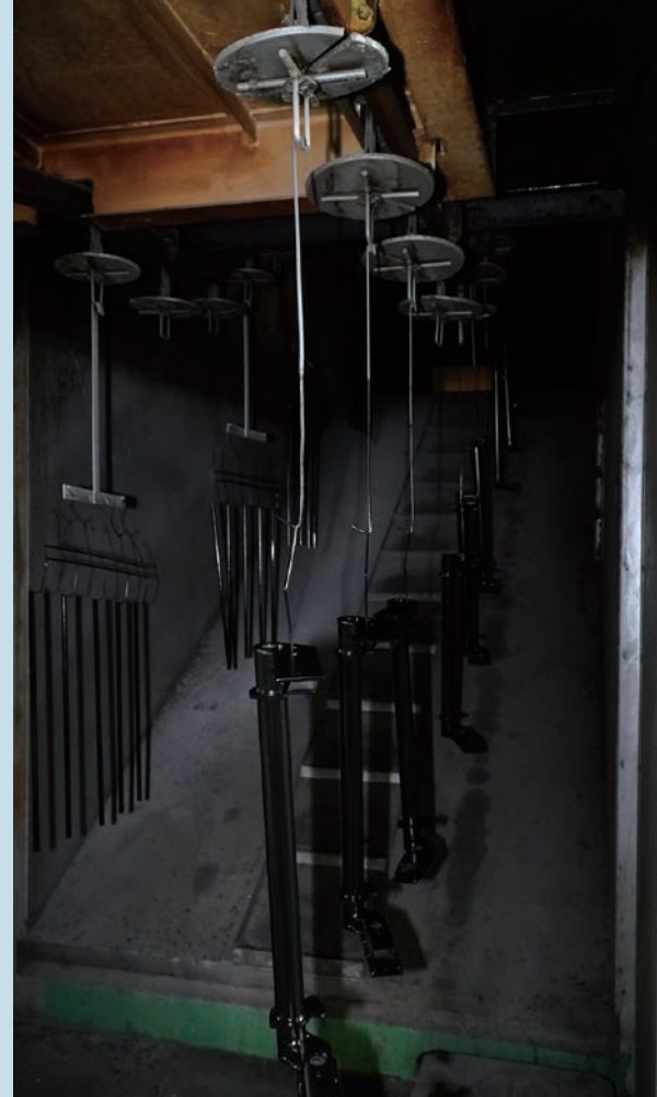
焼き付け乾燥炉出入口
