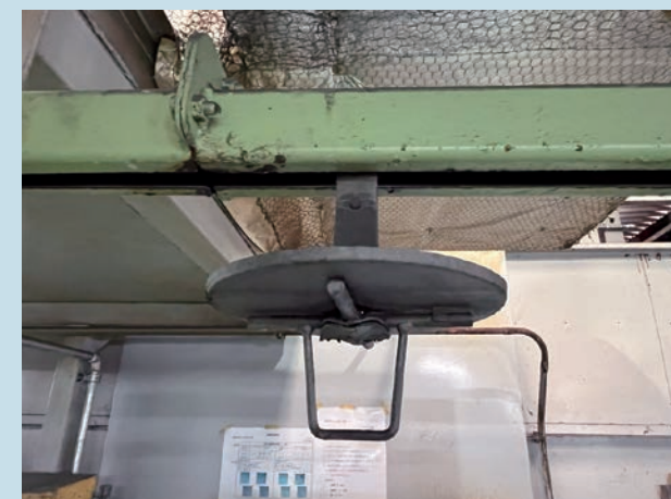
コンベヤーからのゴミ・ブツをキャッチする受け皿
