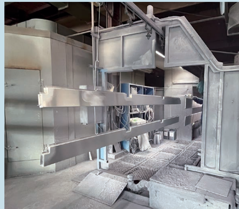
プライマーブース
