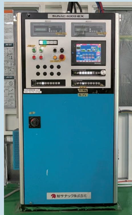
塗装制御盤 (SUNAC 4000EX)
