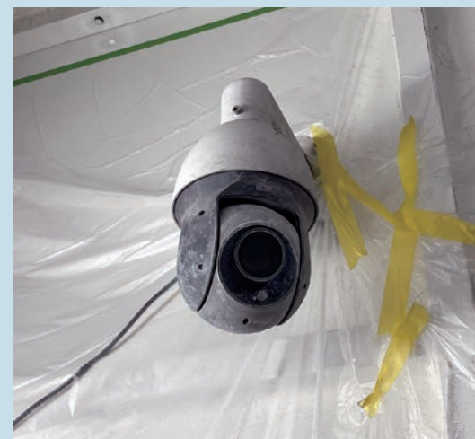
塗装ブース内のカメラで塗装状況を遠隔で確認可能 塗装ラインには5つのカメラが設置してある
