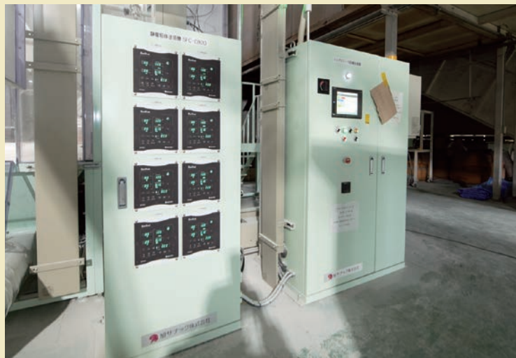
粉体塗装自動ガン制御盤と塗装制御盤
