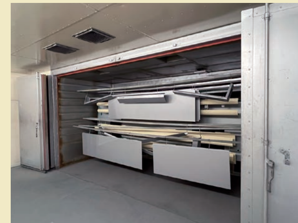
第一工場 バッチ炉
