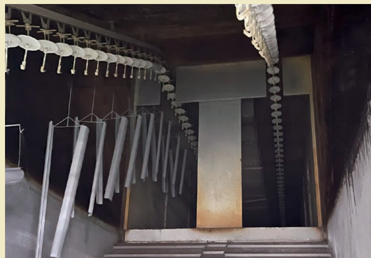
焼き付け乾燥炉出入口
