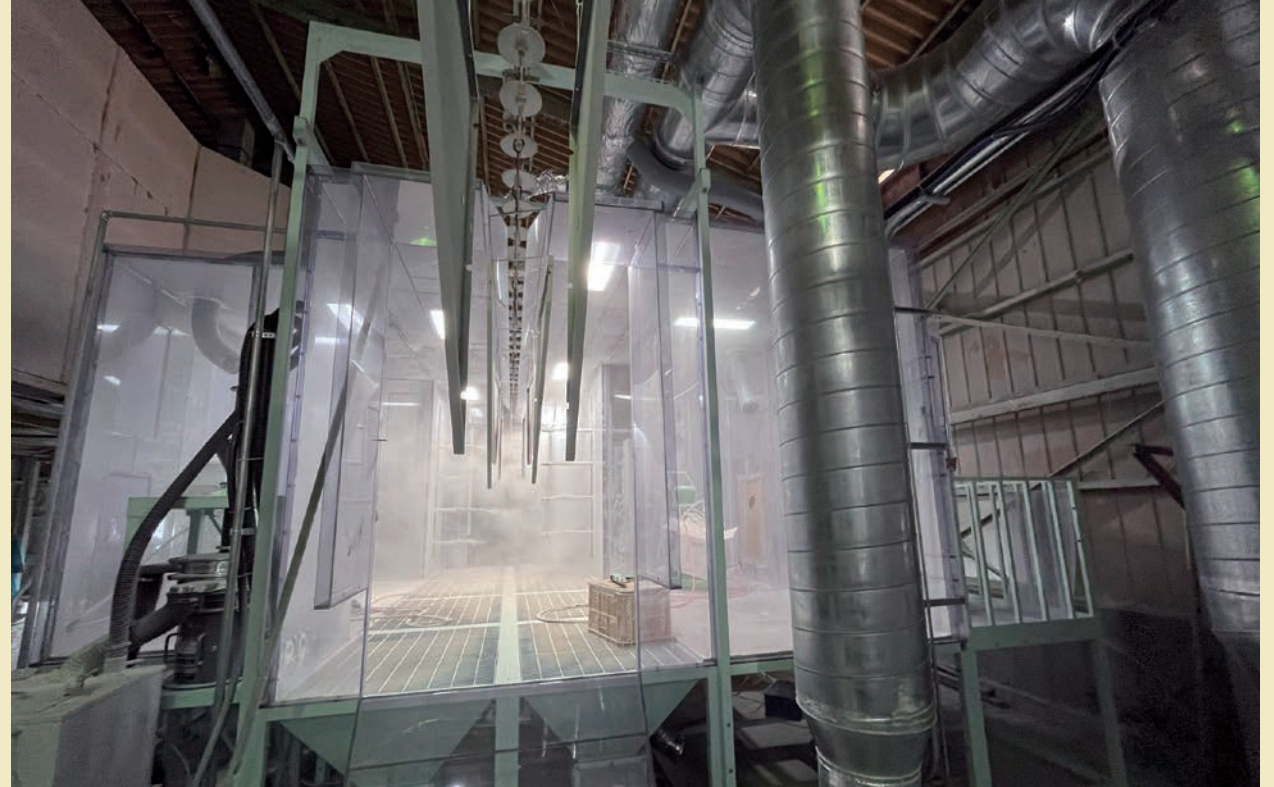
新設された透明樹脂製の粉体塗装ブース
