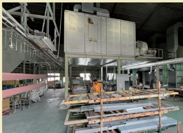
Aライン工場(粉体・溶剤切り替えライン)
