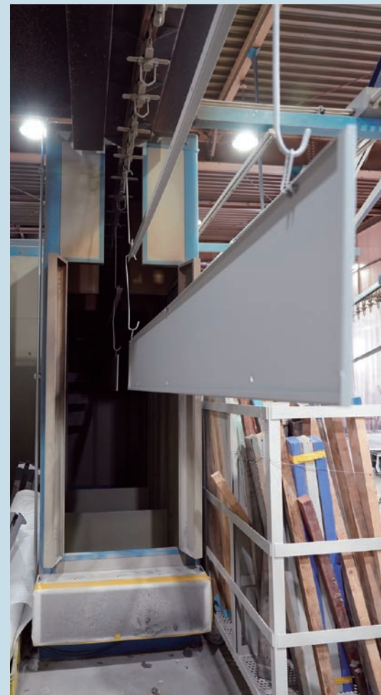
焼き付け乾燥炉出口付近
