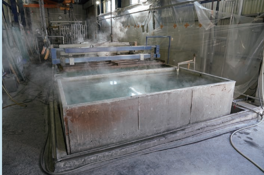
前処理装置 リン酸亜鉛皮膜処理を実施
