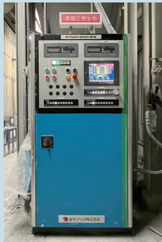
塗装制御盤(SUNAC 4400EX)
