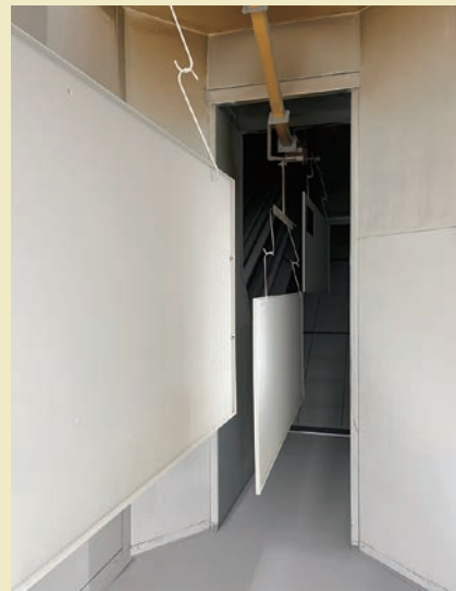
焼き付け乾燥炉入口
