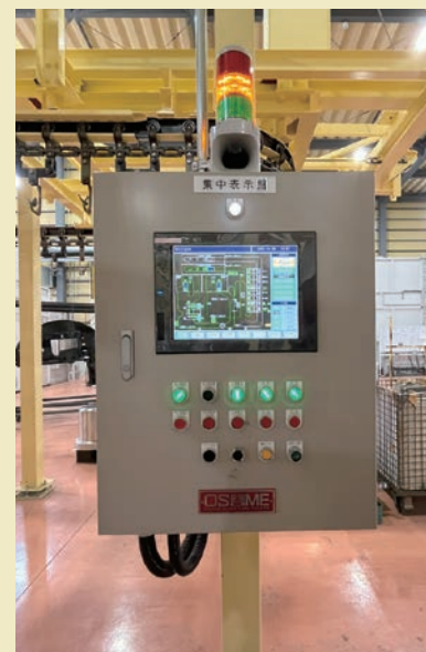
塗装状況を集中表示盤で確認
