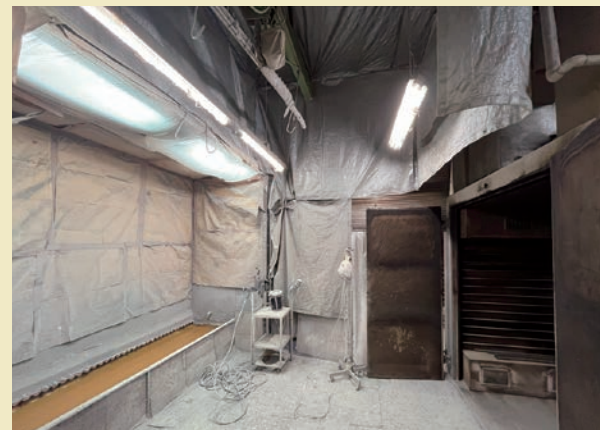
第1塗装班 大型ワーク用塗装ブースとバッチ炉
