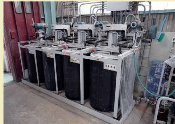
排水処理設備
