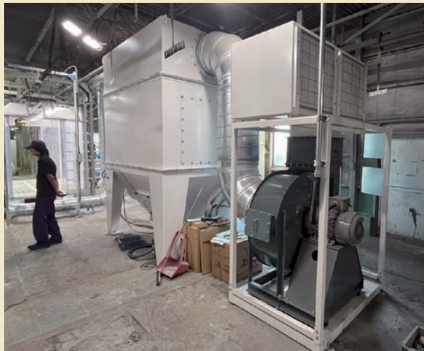
建屋の関係上、高さが確保できないため、 塗料回収装置本体と排気ファンはセパレートして設置
