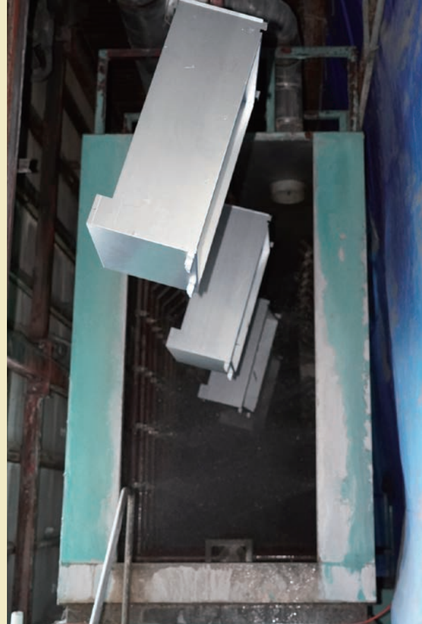
前処理装置 (リン酸亜鉛化成処理) 入口
