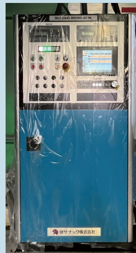
第一製造 塗装制御盤 (SUNAC 2000EX)
