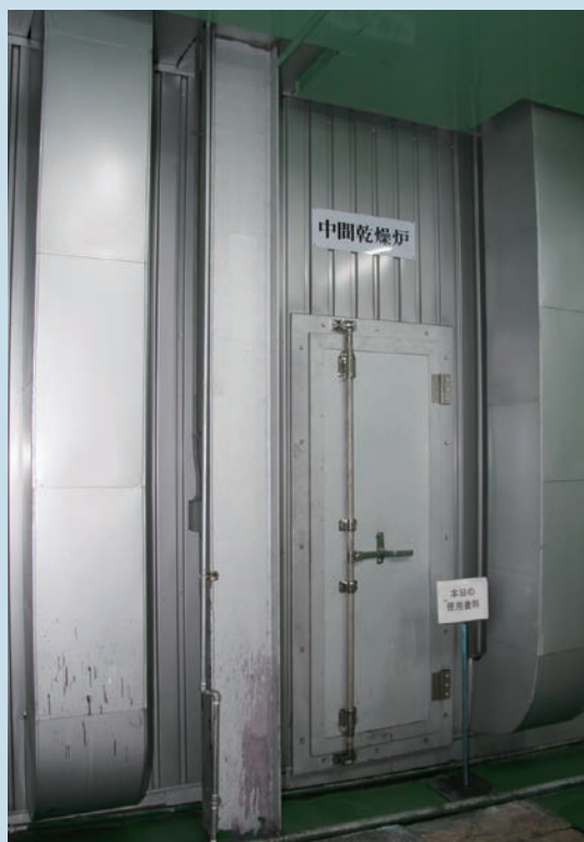
第一製造 中間乾燥炉
