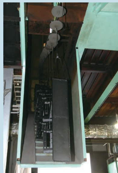
第一製造 焼き付け乾燥炉出口
