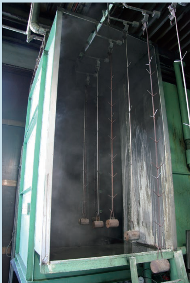
第一製造 前処理装置(リン酸亜鉛／ノックロム化成処理)入口
