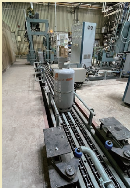
自動搬送のコンベヤを各所に設置
