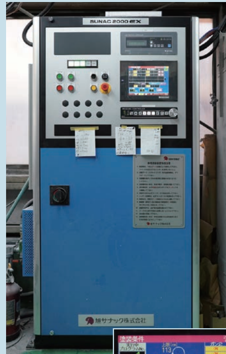
塗装制御盤 SUNAC 2000 EX
