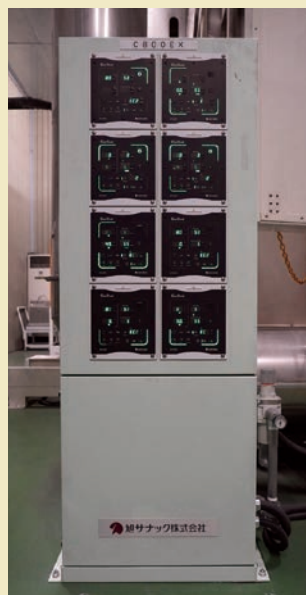
粉体自動ガン制御盤
